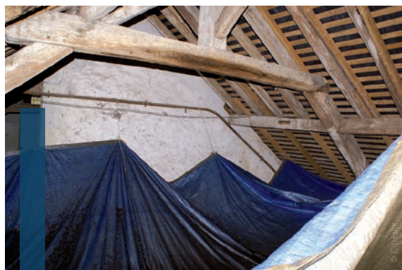
Bâches de protection dans un comble
