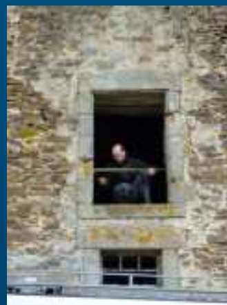
Porte manquante laissant accès aux rapaces
